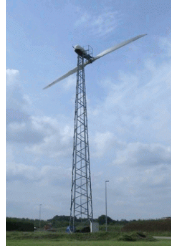
Fig. 32 Gaia Wind 133-11kW turbine
