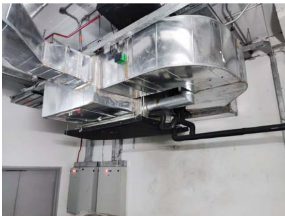
Fig. 8 Fan Coil Unit (FCU)
