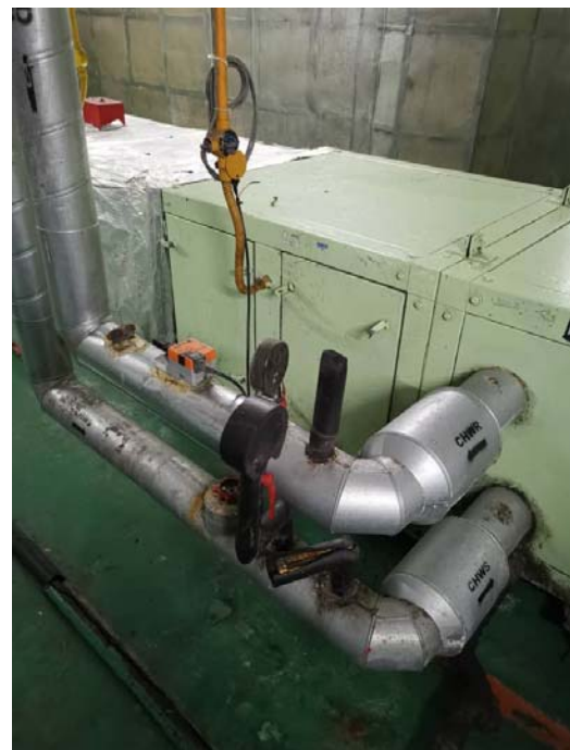
Fig. 9 Air Handling Unit (AHU)
