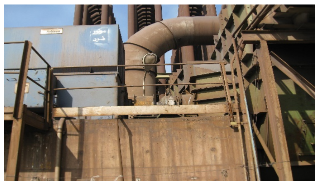
Fig. 1 Motor of fan process
