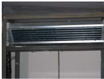
(b) Fan coil unit
